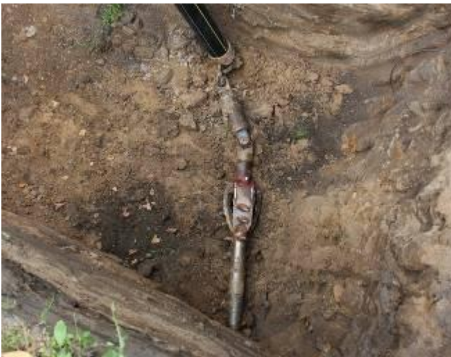
Der Aufweitkopf und das Neurohr werden montiert. Der Aufweitkopf ist eine Eigenkonstruktion von BurMontazh.
