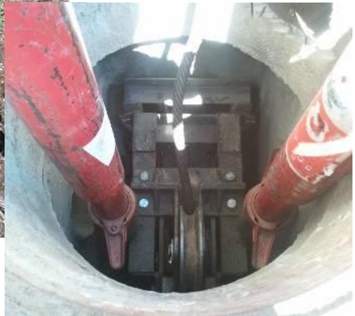
↓ Der Schachtrahmen ist im Schacht Ø 800 mm montiert.
