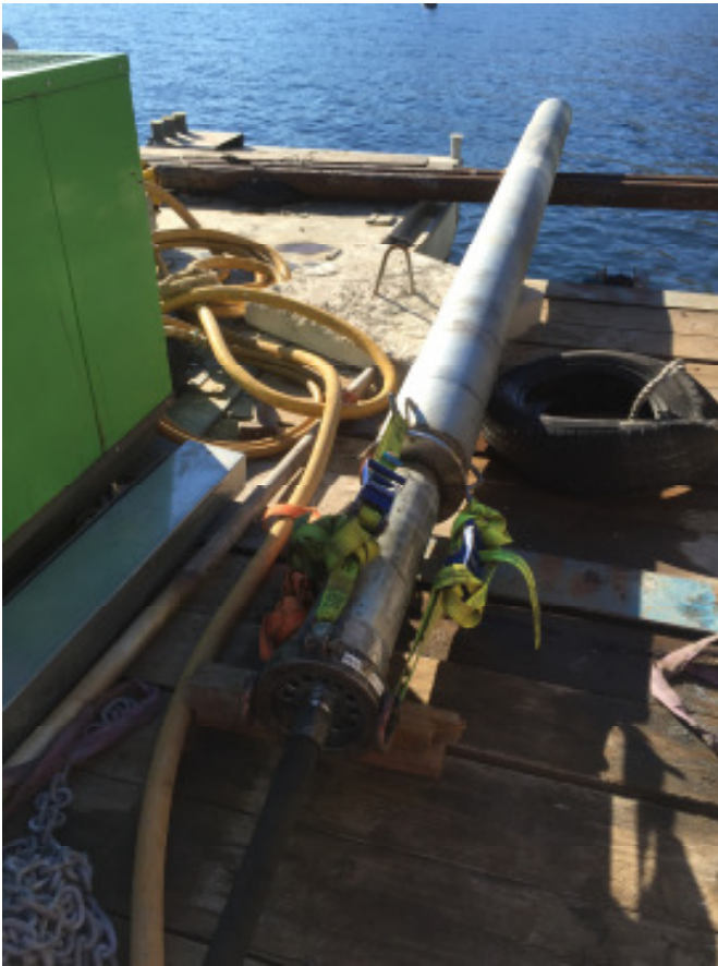
Bild 2: Das Stahlrohr, der Rammring und die Ramme werden mittels drei Spanngurten zusammen gespannt. Der Druckring am hinteren Ende der Ramme verfügt über fünf Anschlagpunkte.
